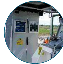
Electric Panel board Armoire électrique
